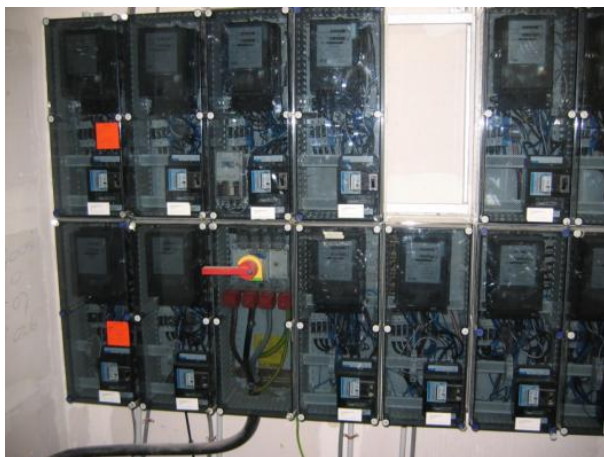
Compteurs BT (immeuble)
