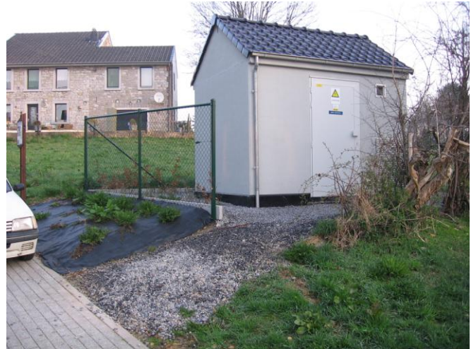
Cabine de distribution « Heckstraße » à Raeren.
